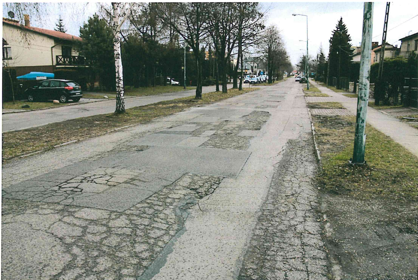
Załącznik - stan nawierzchni ul. Słonecznej w Pszczynie na osiedlu Kolonia Jasna, zdjęcia - luty 2016 r.
